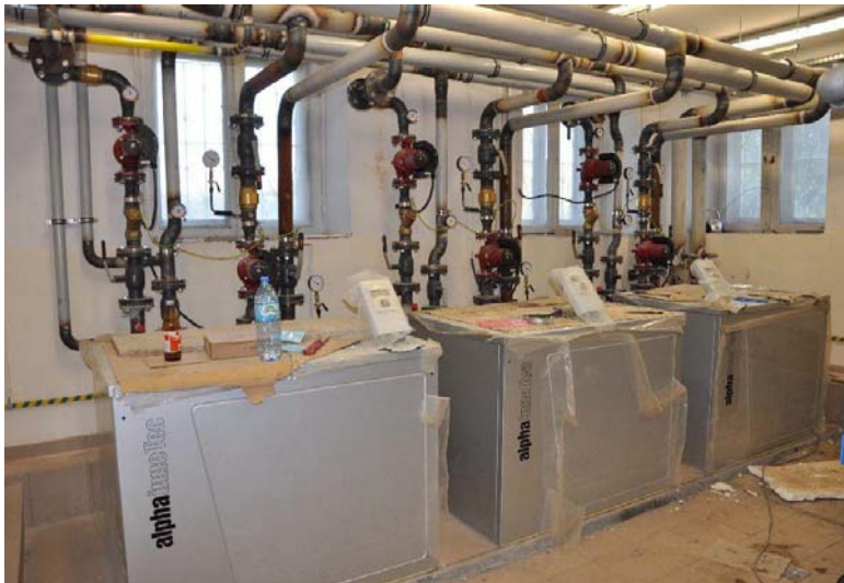
Figura 6. Pompa di calore in CDR Brwinow
