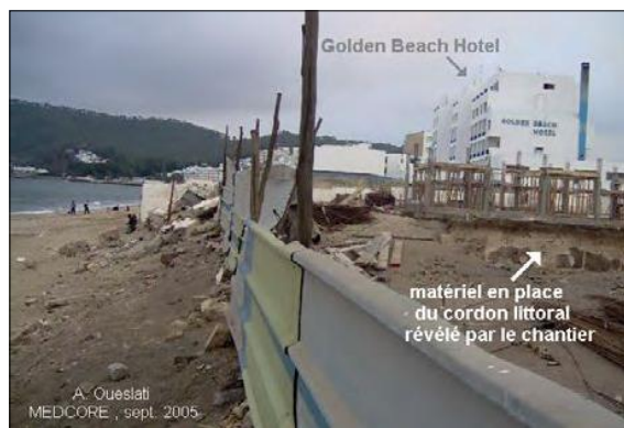
Fig. 21- A Mdiq, au contact de l'hôtel Golden Beach : cette photo, prise en 2005, montre un beau sable clair caractéristique du cordon littoral défoncé par un important chantier de construction. On en comprend aussi que l'hôtel Golden Beach et la ligne de bâtiments de front de mer sont implantés aux dépens d'un tel cordon. Aujourd'hui, l'emplacement du chantier est occupé par un important bâtiment séparé de la mer par une petite voie piétonne que protège un mur de soutènement !
