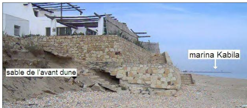
Fig. 6- Le déclenchement des formes de dégradation surtout suite à des constructions empiétant sur la plage peut être très rapide. Ici, l'exemple d'une résidence très récente à mi-chemin entre Mdiq et le port de Kabila ; la terrasse construite sur l'avant dune et partiellement sur la partie interne du bas de plage est affouillée à l'occasion des tempêtes.
