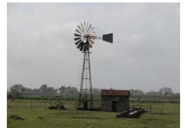
Una pompa idraulica
