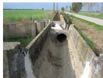
Canali per l'irrigazione
